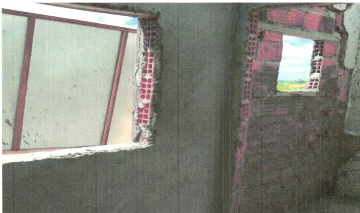
FOTO 10 – CHAPISCO APLICADO EM ALVENARIA (COM PRESENÇA DE VÃOS) E ESTRUTURAS DE CONCRETO DE FACHADA, COM EQUIPAMENTO DE PROJEÇÃO. ARGAMASSA TRAÇO 1:3 COM PREPARO EM BETONEIRA 400 L. AF_06/2014 e MASSA ÚNICA, PARA RECEBIMENTO DE PINTURA OU CERÂMICA, ARGAMASSA INDUSTRIALIZADA, PREPARO MECÂNICO, APLICADO COM EQUIPAMENTO DE MISTURA E PROJEÇÃO DE 1,5 M3/H EM FACES INTERNAS DE PAREDES, ESPESURA DE 5MM, SEM EXECUÇÃO DE TALISCAS. AF_06/2014
